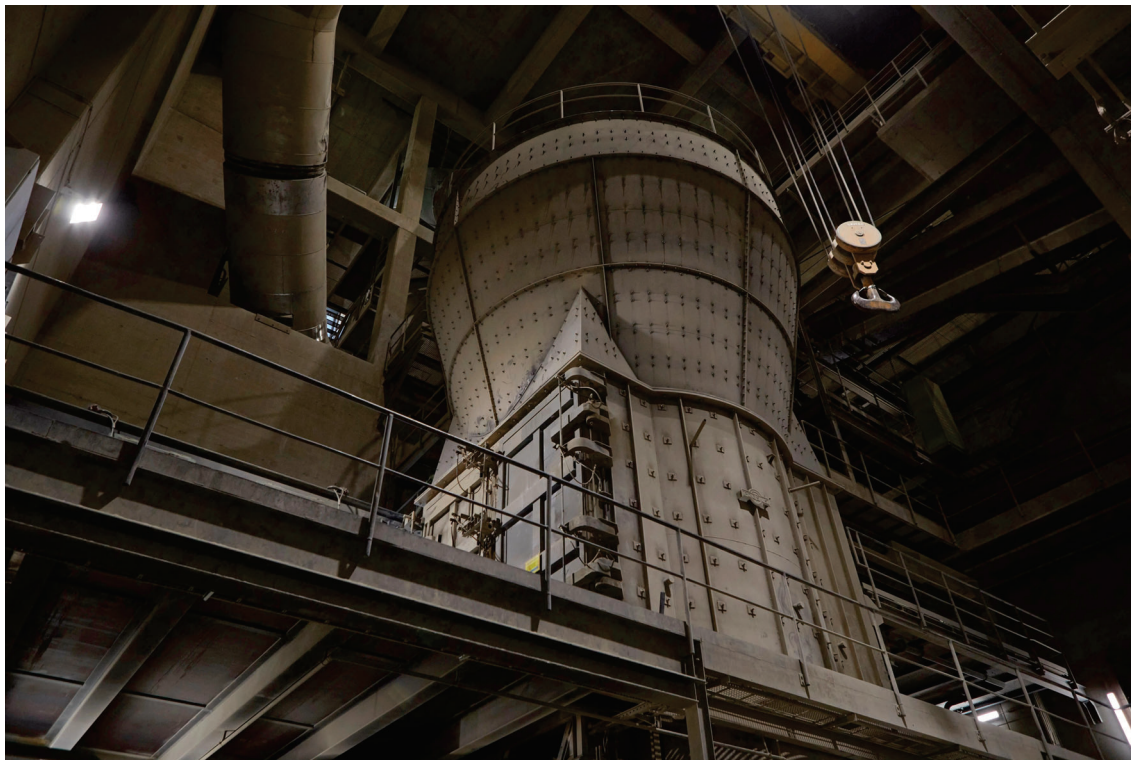
Vertikale Rohmaterialmühle zur Zementherstellung. Henry Muchenberger
